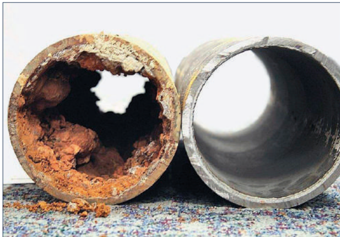
Oksygen fører til korrosjon. Dette skaper problemer.
